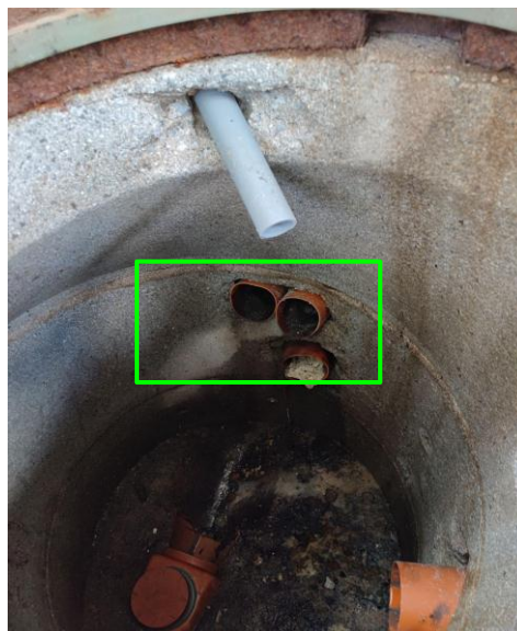
Fig. 3: Situación de las tuberías de drenaje de aguas residuales. Se observa la pendiente inadecuada en las tuberías señaladas en color verde
